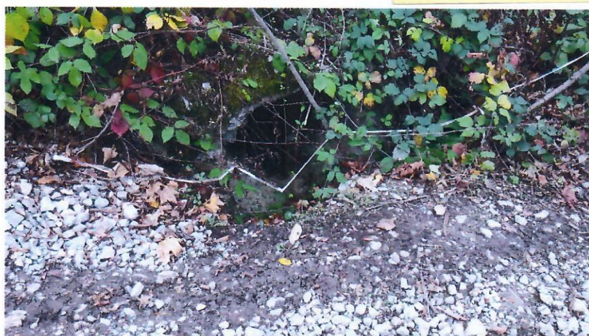
Сн.12 Разрушен водосток в подотдел 136 а
